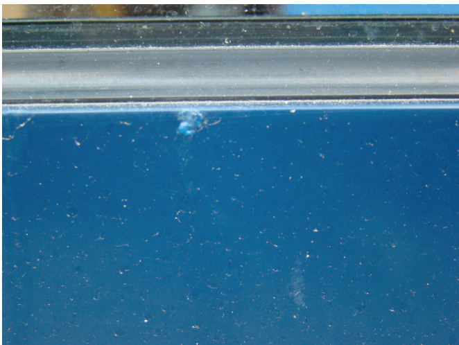
Lakdefect op de onderregel van een raam.
